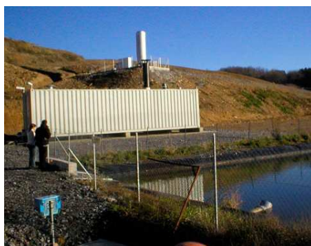
Figure 32: Photo d'une configuration typique d'une installation d'osmose inverse à 2 étages avec lagunage des lixiviats, rejet direct du perméat et re-infiltration du concentrat (72 m 3 /j, CSDU Pays des Graves, Hautes-Pyrénées, Commune de Lourdes, France, mise en service en 2004)
