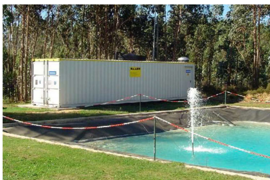
Figure 34 : Photo d'une configuration typique d'une installation d'osmose inverse à 2 étages avec lagunage du perméat (140 m 3 /j, CSDU de Tondela, Portugal, mise en service 2004)
