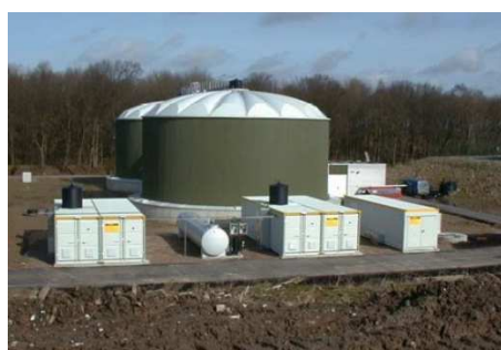
Figure 33 : Photo d'une configuration typique d'une installation d'osmose inverse à 2 étages avec réservoirs de lixiviats, rejet direct du perméat et ré-infiltration du concentrat (350 m 3 /j, lixiviat Niemark, Luebeck Germany, mis en service en 1999).
