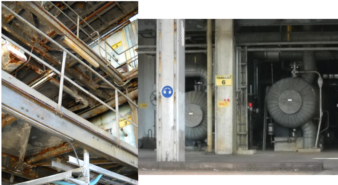
Figure 34 Vues de différents équipements donnant un aperçu de la complexité des situations d'accès aux équipements et ouvrages à désamianter ( Source : EDF )
