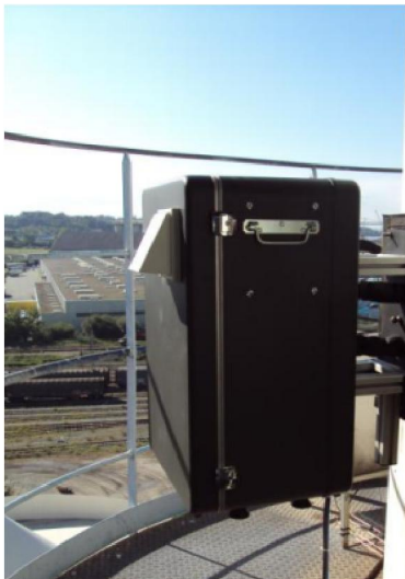
PPS installé sur une cheminée industrielle (Source : ADDAIR)
