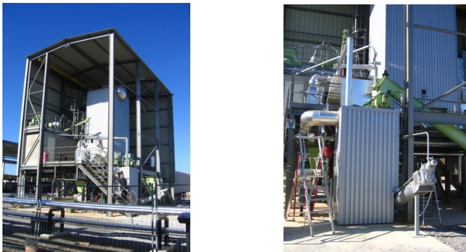
Figure 81 : Installation PyroAl de Lacq et dispositif LFD associé
