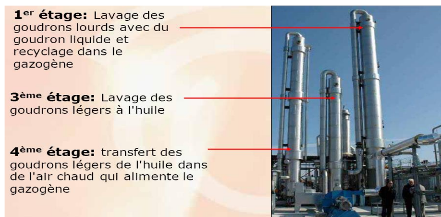
Figure 76 : Procédé de lavage des goudrons (Olga) disposé en sortie des installations de gazéification PRME (Eneria)
