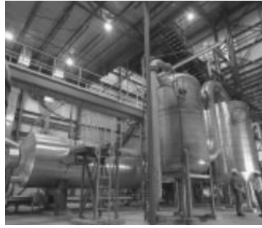
Figure 27 : Installation pilote de Jonquière (Québec, Canada)
