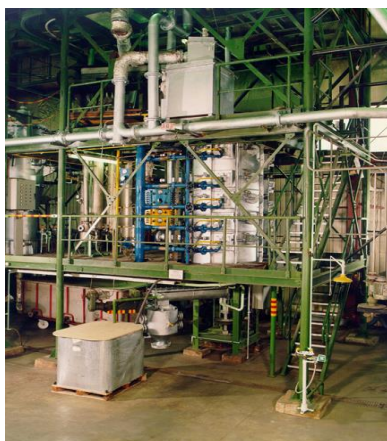
Figure 45 : Plateforme d'essais CMI
