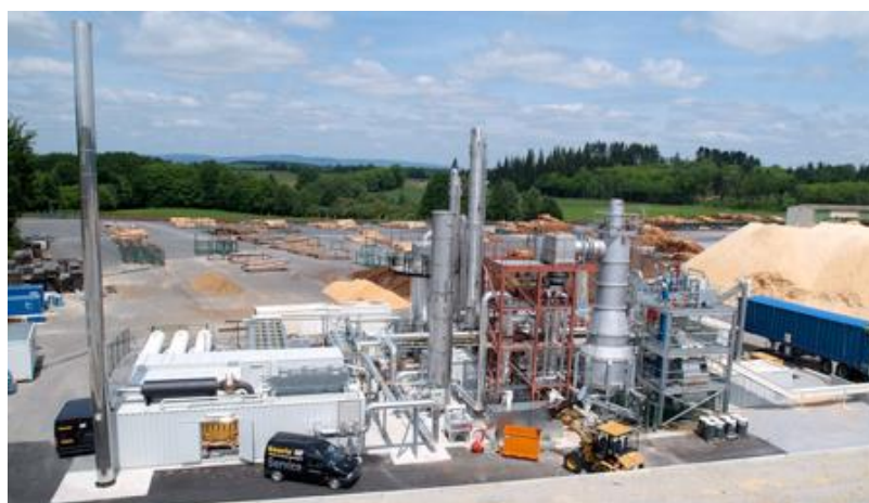
Figure 75 : Unité EBV-Eneria à Moissanes
