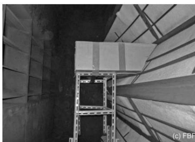
Figure 49. Installation de filtres électrets en medium polypropylène dans le métro (d'après Li (2010))
