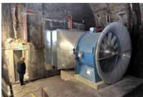
Figure 6. Un ventilateur du réseau de ventilation du métro de Paris (d'après [16]).
