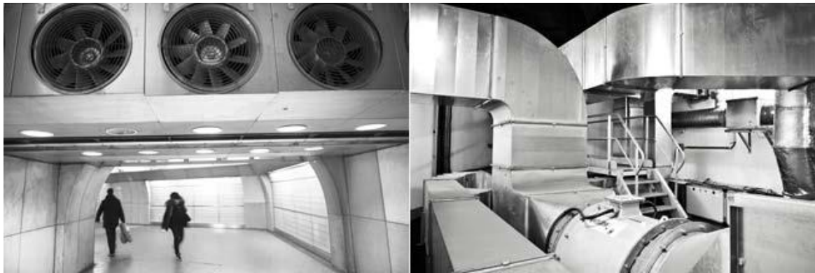
Figure 7. Installation de ventilation du métro parisien (d'après [15]).
