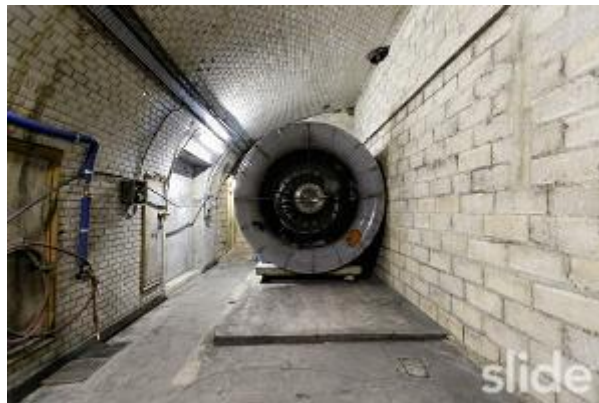
Figure 10. Un ventilateur dans un accès abandonné (d'après [18]).
