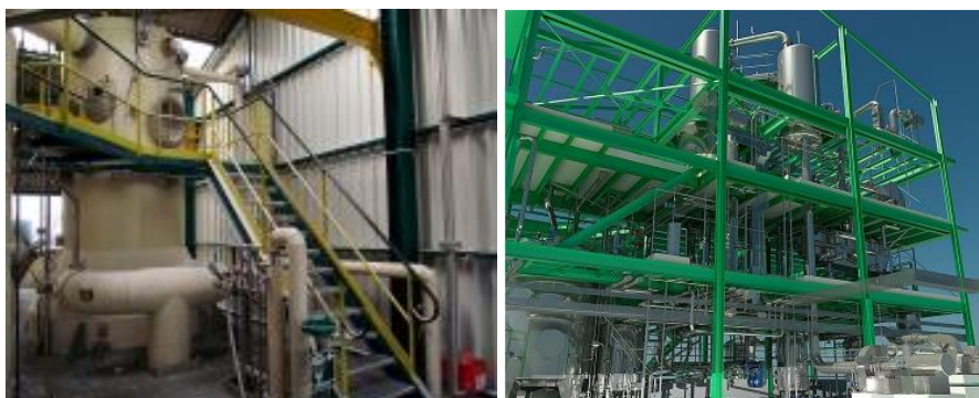
Photo 7 : Installation de cristallisation de sulfate de sodium [120]
