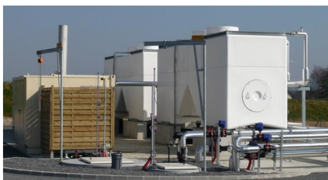
Traitement de lixiviat : 2 modules DHC08 connectés à une chaudière biogaz
