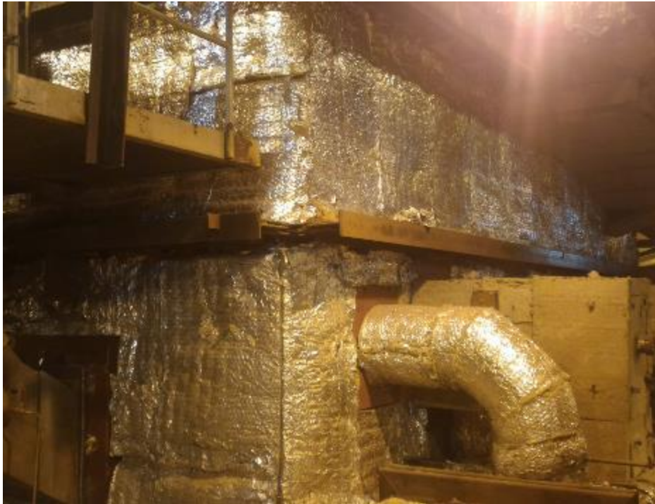
Figure 91 - Fond de la chaudière à lit fluidisé bouillonnant (isolé de l'extérieur) (RECORD, 2018)
