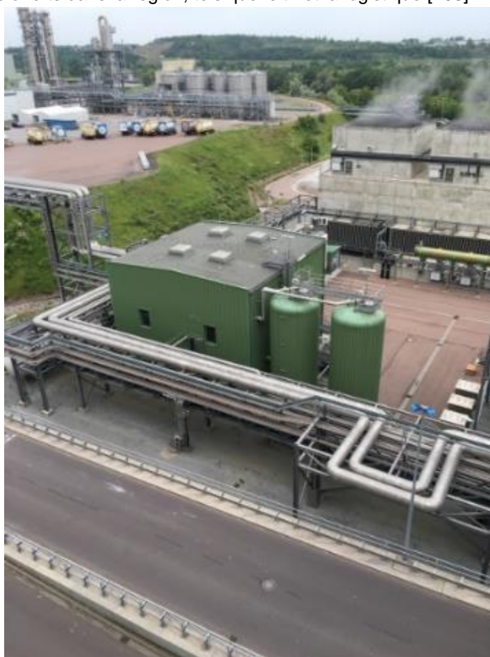
Figure 108: Unité abritant la turbine et canalisations d'alimentation en vapeur (RECORD, 2018)
