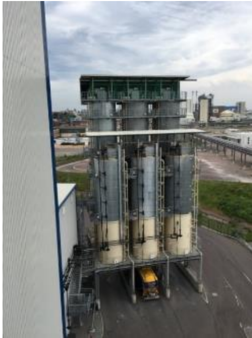
Figure 110: Silo de stockage des cendres volantes (RECORD, 2018)
