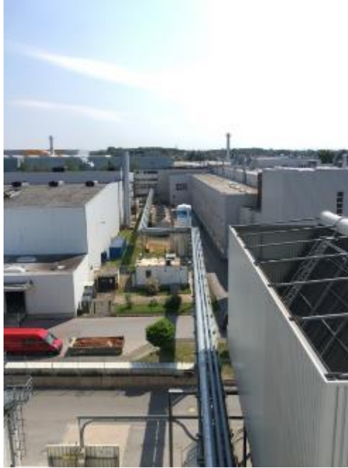
Figure 81: Canalisation transportant la vapeur de MVV à Continental (RECORD, 2018)
