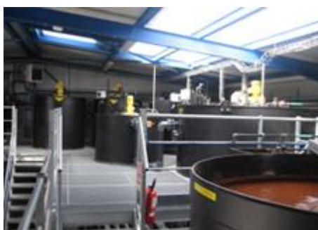
Photo 2. Cuve de traitement par Fenton [71]
