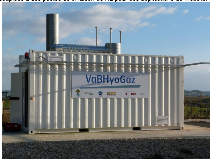
Figure 165 - Vue de l'installation pilote de 10 kg H2 /jour sur le site de Tryfil Source : HERA, Tryfil, 2014
