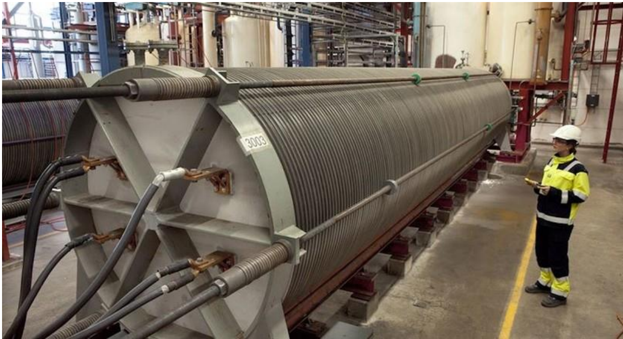
Figure 25 - Exemple d'électrolyseur alcalin de forte puissance, source Nouryon
