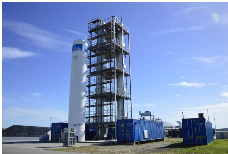
Figure 104 – Installation de Pfirmasens-Winzeln (2000kW electrolyseur , 2016), source PFI
