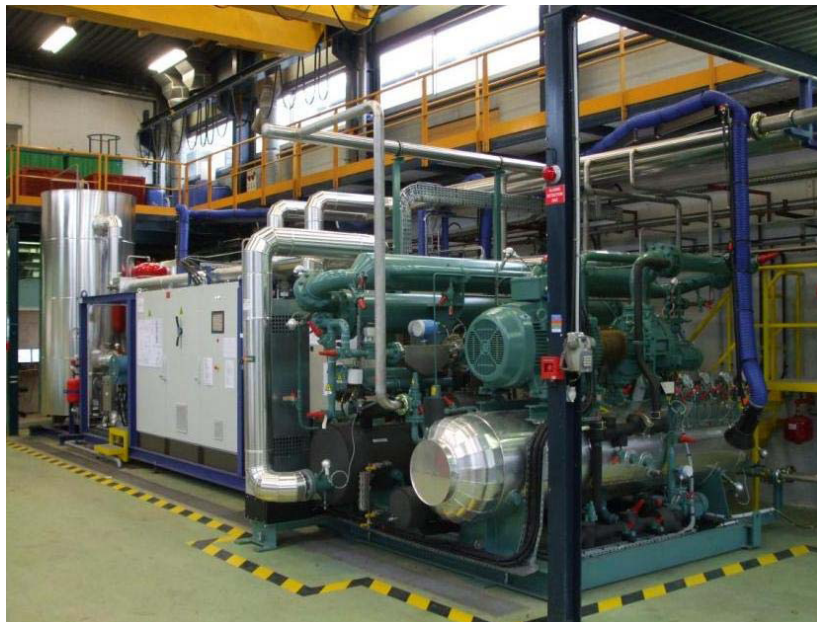
Figure 15 : banc d'essai d'une PAC HT Industrielle de 700 kW [5]
