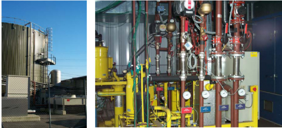
Figure 13 : Installation à l'usine de Nant-de-Chatillon (Genève)
