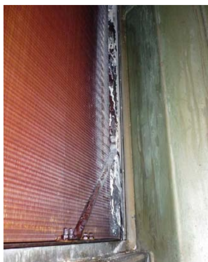
Traces dues à la condensation acide
