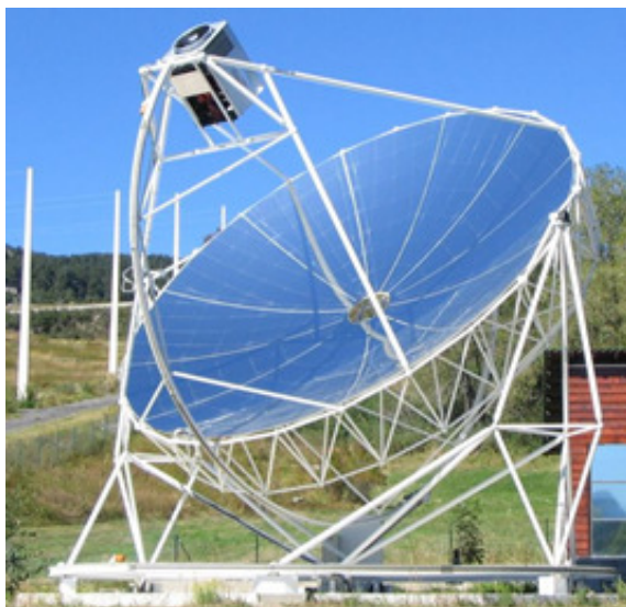
Figure 7 : Installation « Dish Stirling »
