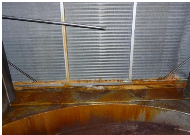
Vue sur batterie (6 mois de fonctionnement)
