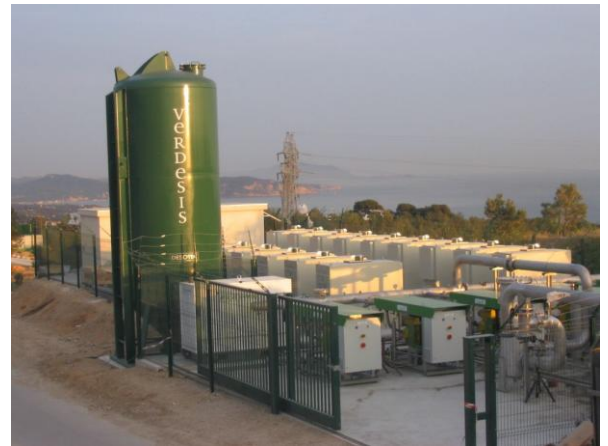
Aperçu de l'installation biogaz à la CIOTAT
