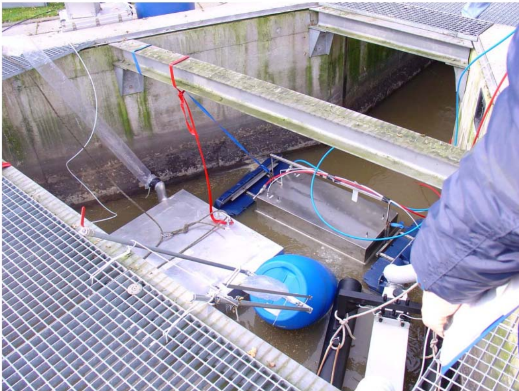
Figure 30 : Photographie des 4 chambres testées dans le cadre de la VDI
