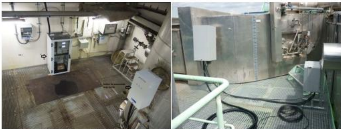
Photographie du site : mesure en cheminée (à gauche) et en post-chaudière (à droite)
