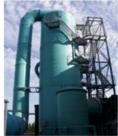
Tour de lavage MercOx
