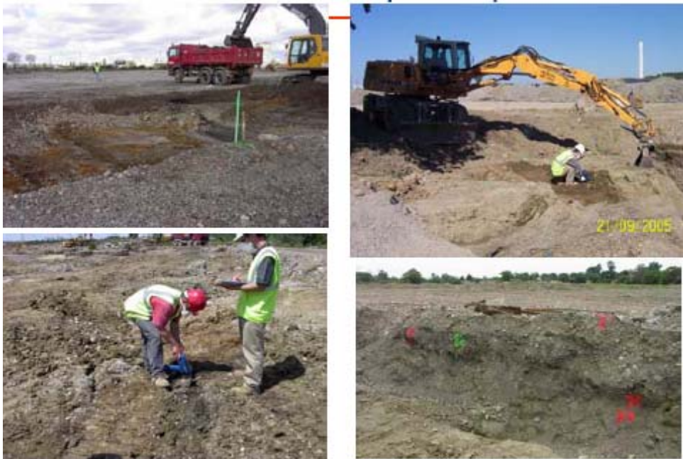
Figure 30: Excavation et contrôle de zones polluées par les métaux - Grande Paroisse (S3PI - ORDIMIP)
